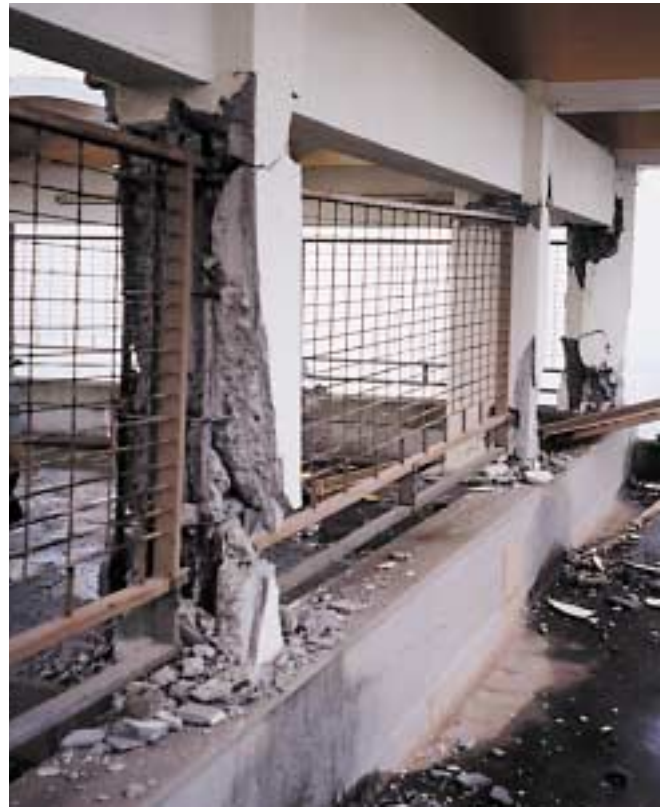
国民宿舎「音戸ロッジ」における被害（広島県呉市）
